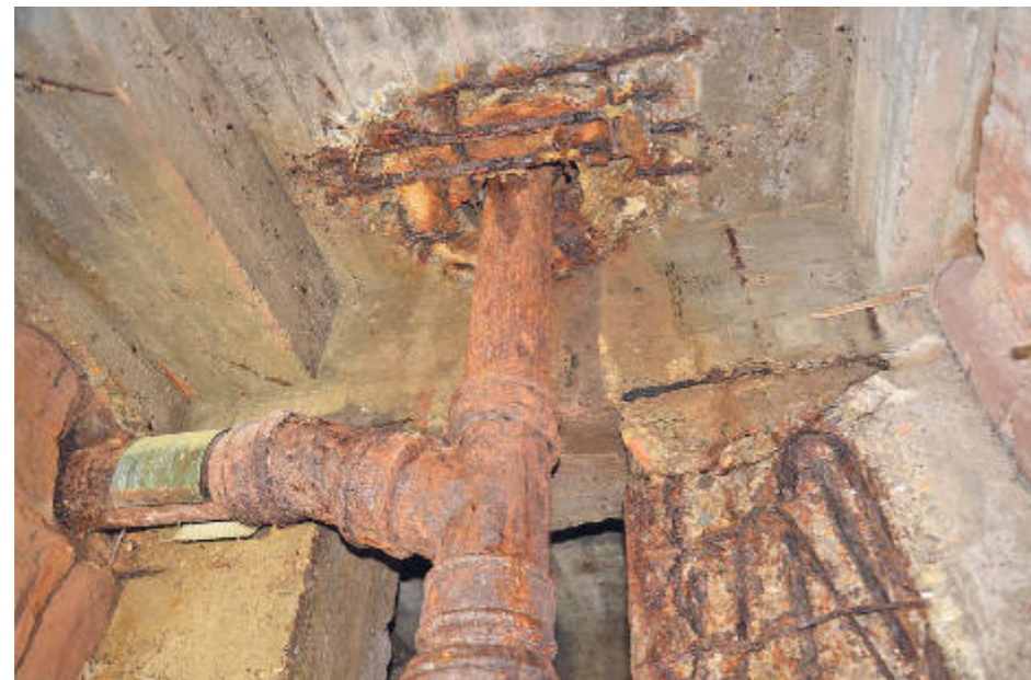
Marode. Im Anbau der Römerbrücke zeigen sich die Schäden, die zur Teilsperierung des Bauwerks geführt haben: Beton ist großflächig abgeplatzt, die Stahlbewehrung liegt frei und weist Rostschäden auf. Foto: Presseamt/kg
