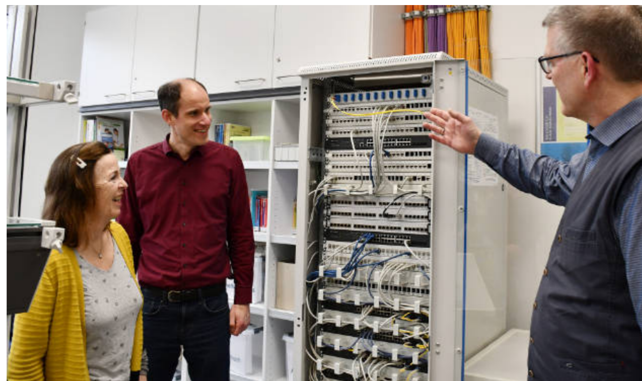
Knotenpunkt. Alexander Koch vom Hochbauamt (r.) erläutert Bürgermeisterin Elvira Garbes und Baudezernent Dr. Thilo Becker Details zum Schaltschrank in einem FWG-Fachraum. Foto: Presseamt/pe
