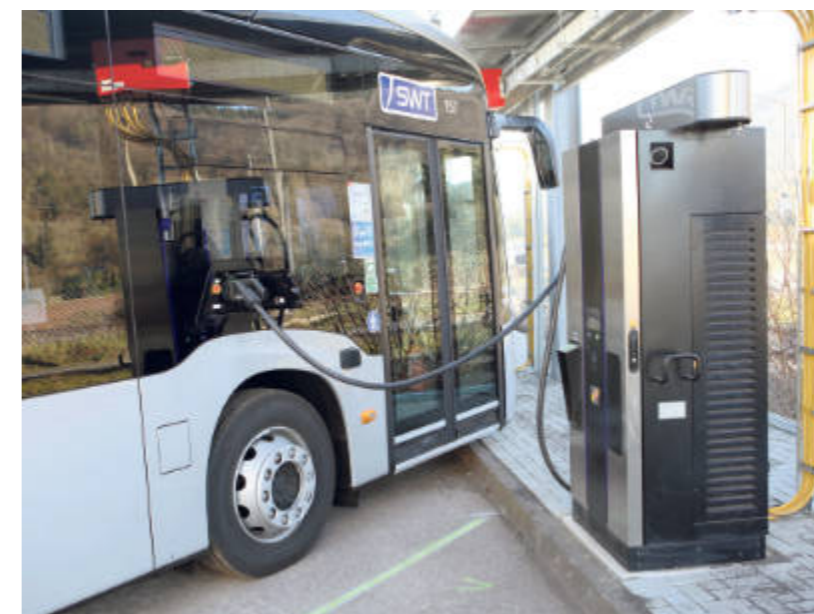
Strom statt Diesel. Auf dem Betriebshof der Stadtwerke in der Gottbillstraße werden die E-Busse aufgeladen. Foto: Stadtwerke
