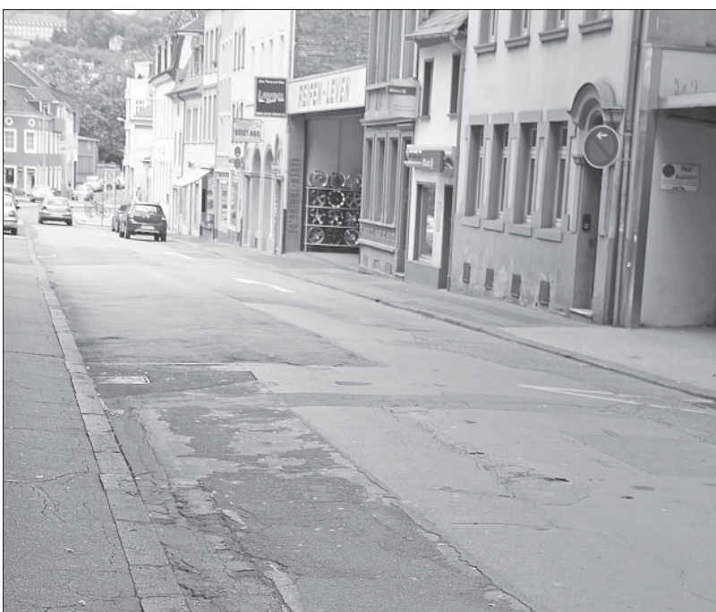
Flickenteppich. Der Fahrbahnbelag der Moselstraße wurde in der Vergangenheit vielfach ausgebessert. Nun steht eine umfassende Sanierung mit Verbreiterung der Gehwege an. Foto: PA
