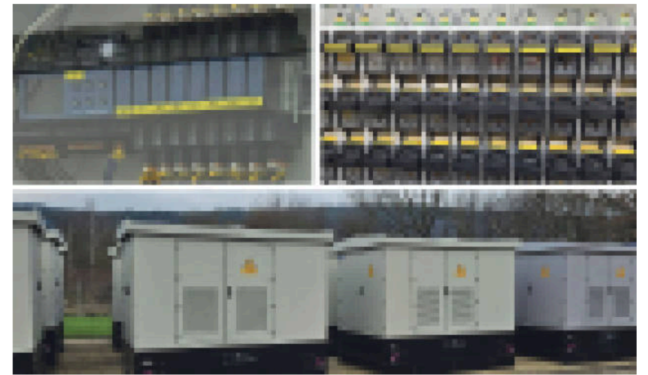
Modernisiert. Zur intelligenten Führung des Stromnetzes sind die neuen Ortsnetzstationen der SWT mit der neuesten Digitaltechnik ausgestattet. Fotomontage: Stadtwerke
