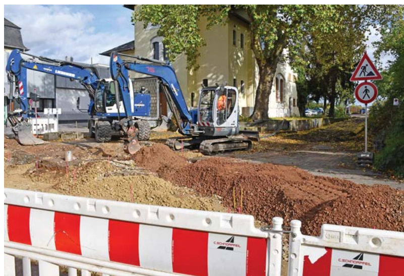
Aufbruch. An der Einmündung des künftigen Radwegs in die Schönbornstraße laufen die vorbereitenden Leitungs- und Kanalarbeiten. Foto: Presseamt/kig
