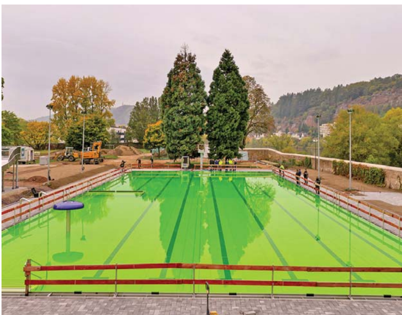
Grün statt blau. Mit dem grün eingefärbten Wasser im Nordbad wird deutlich, dass die zahlreichen Bodendüsen das Desinfektionsmittel optimal im Becken verteilen. Foto: SWT
