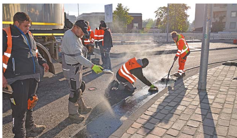
Handarbeit. Mitarbeiter der Firma Schnorpfeil präparieren die Entwässerungsrinne am neuen Römerbrückenkreiseln in Trier-West mit heißem Gussasphalt. Foto: Presseamt/kig
