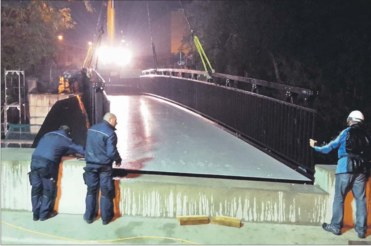
Maßarbeit. Während der Zugfahrpausa in der Nacht zum Sonntag wird der neue Überbau der Hermesbrücke per Kran auf die Widerlager gelegt. Mitarbeiter der Firma PML überwachen die Prozedur. Foto: Tiefbauamt
