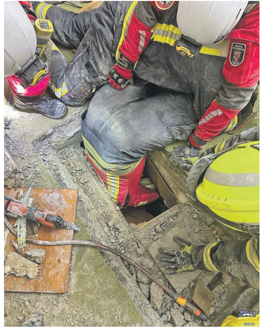
Kopfbüßer. Der Trierer Feuerwehrmann und Trümmerrettungsexperte Christoph Reuter in den Resten des Gebäudes, unterstützt von Höhenrettern.
