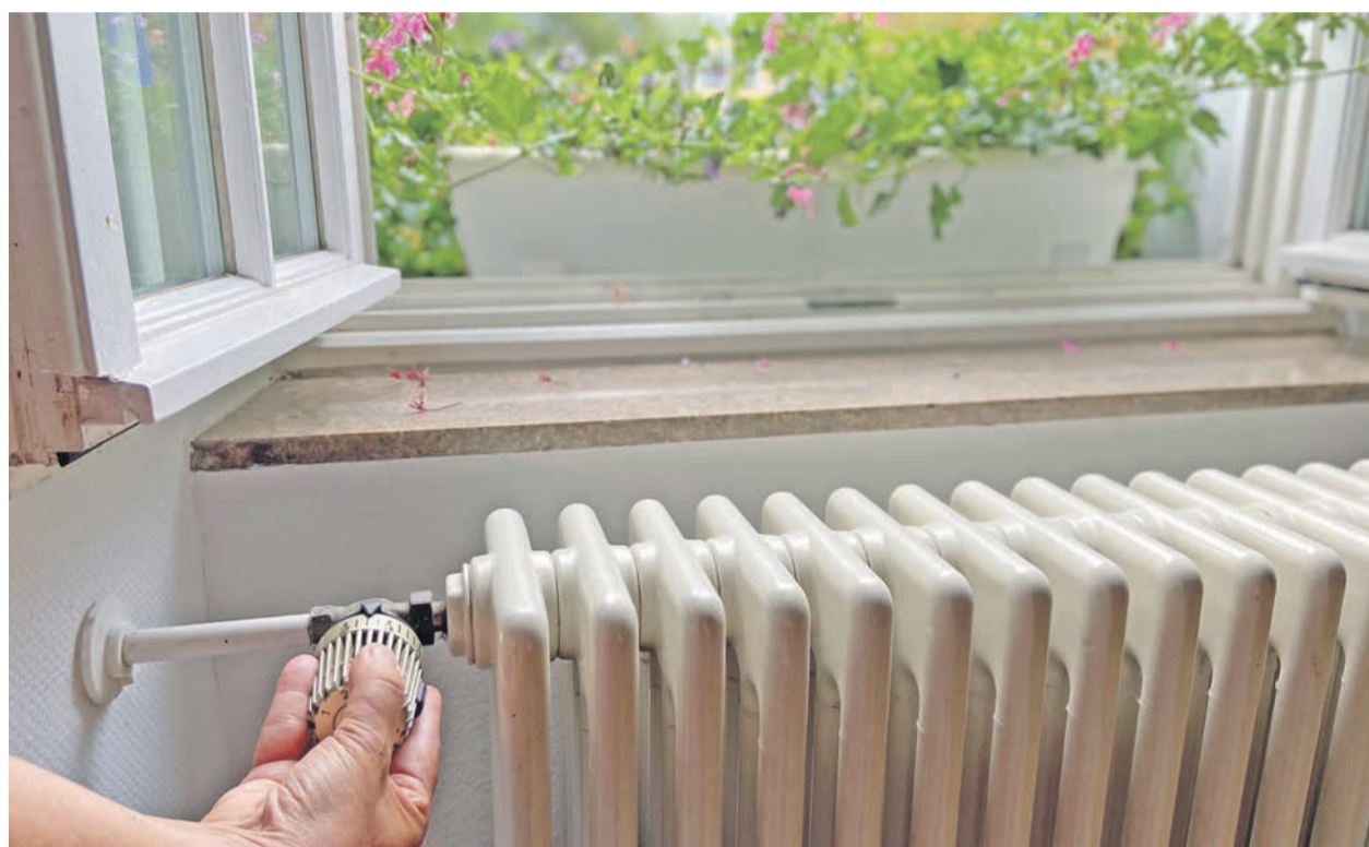
Runter statt hoch. In den Büros der Verwaltung wird im Herbst und Winter die Heizung runtergedreht, um Energie einzusparen. Foto: Presseamt/gut
