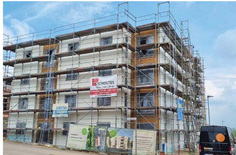
Endspurt. Die ISB förderte 2022 unter anderem 60 Wohnungen mit günstigen sowie preisgebundenen Mieten im Wohngebiet Castelnau-Mattheis. Bei dem Projekt der Firma Imprinzip GmbH & Co. KG wird das Haus III zuerst fertiggestellt. Die Gebäude entstehen in Holzhybrid-Bauweise. Foto: Imprinzip
