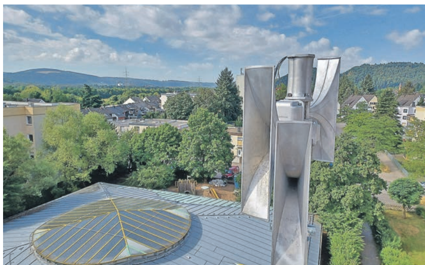
Bessere Alarmierung. Die Alemannenstraße ist einer der Standorte in Ehrang, wo bereits eine moderne Sirene installiert ist. Foto: SWT
