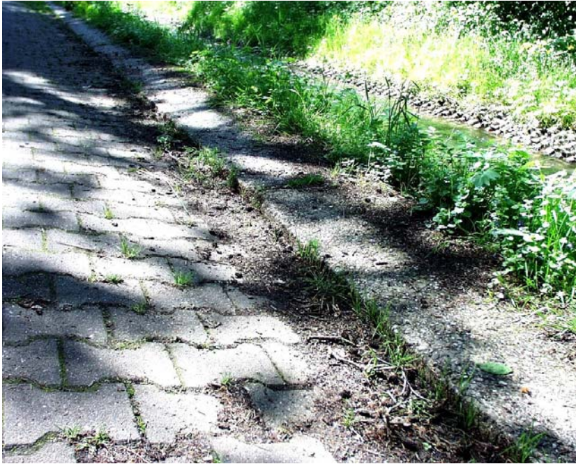
Abb. 28: akute Unfallgefahr an den Rad- und Fußwegen am Oewiger Bach
