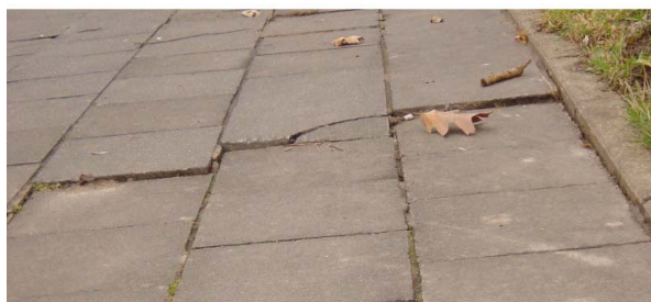
Abbildung 33: Schlechte Qualität der Gehwege (2)
