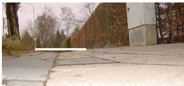
Abbildung 32: Schlechte Qualität der Gehwege (1)
