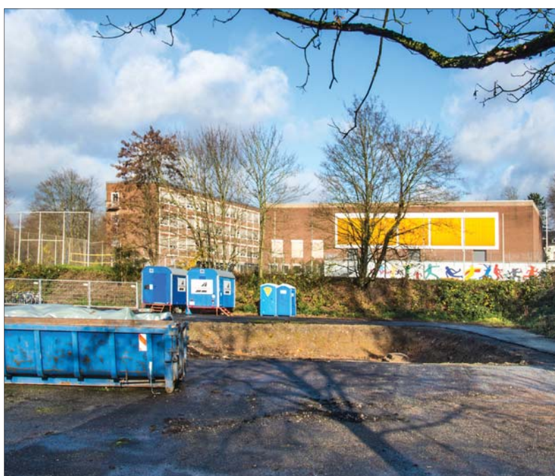
Zwischenlager. Der Bodenaushub in den blauen Containern muss in der Verbrennungsanlage Herne entsorgt werden. Die Grabungsgruben werden verfüllt und der Parkplatz wieder hergerichtet. Archivfoto: Presseamt
