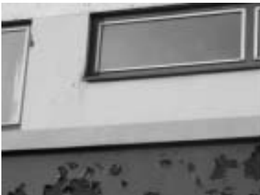
Abb. 9: Außenanstrich ca. 40 Jahre nicht erneuert
