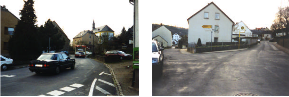
Abb. 8 u.9: sanierungsbedürftige Straßen bzw. Straßenränder
