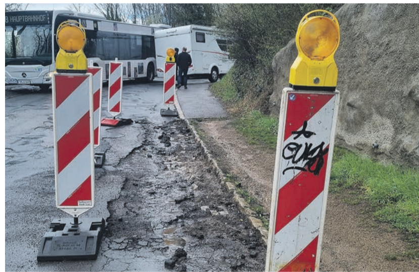
Asphaltwunde. Die heftigen Fahrbahnschäden auf der Sickingenstraße sind derzeit mit Absperrbaken gesichert. Foto: Presseamt/pe
