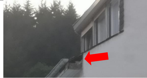
Abbildung 35: potentielle Quartieröffnung auf der Rückseite des Wohnhauses
